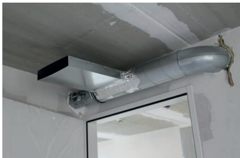
Ruime kanalen maken het ventilatiesysteem energiezuinig.
